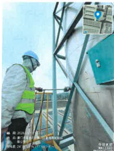
308 车间总排口 (DA021)
