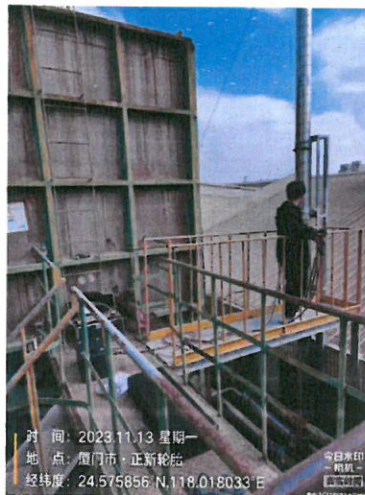
208 检修车间排气筒出口 (DA055/55 号排气筒)
