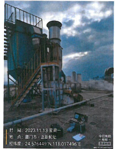
504 检修车间排气筒出口 (DA046/46 号排气筒)
