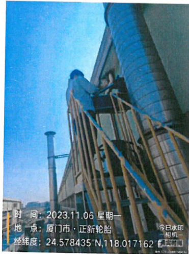
04 成型车间排气筒出口 (DA034/34 号排气筒)
