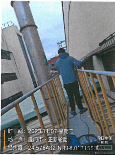
02 检修车间排气筒出口 (DA043/43 号排气筒)
