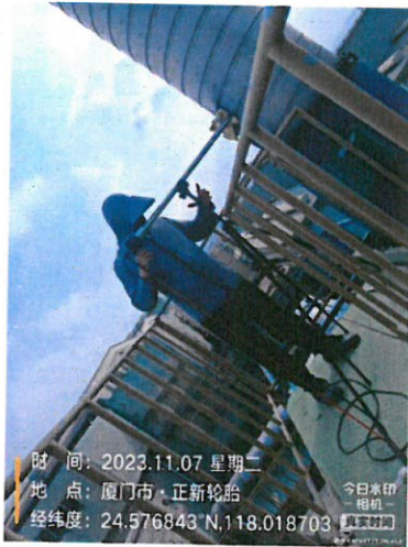
302 成型车间排气筒出口 (DA036/36 号排气筒)
