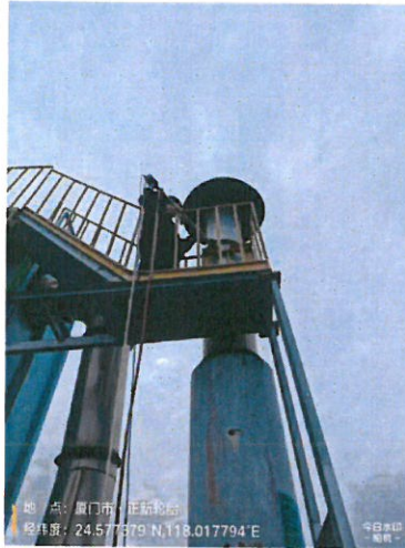
304 检修车间排气筒出口 (DA045/45 号排气筒)
