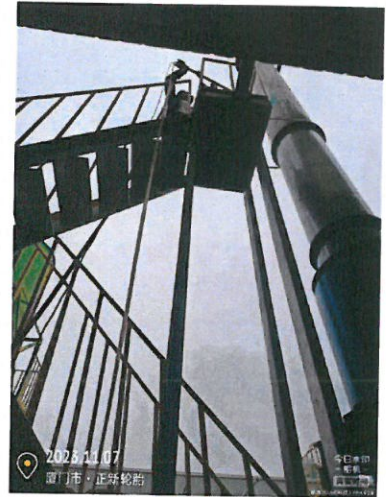
04 成型车间排气筒出口 (DA035/35 号排气筒)
