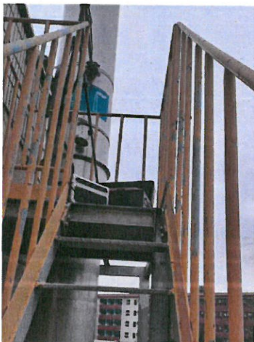
14 配药车间排气筒出口 (DA051/51 号排气筒)
