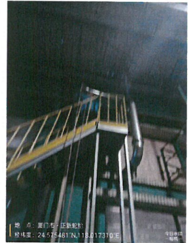
204 钢丝车间排气筒出口 (DA050/50 号排气筒)
