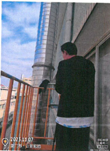
502 成型车间排气筒出口 (DA039/39 号排气筒)
