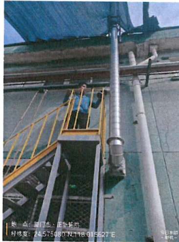
203 检修车间排气筒出口 (DA048/48 号排气筒)
