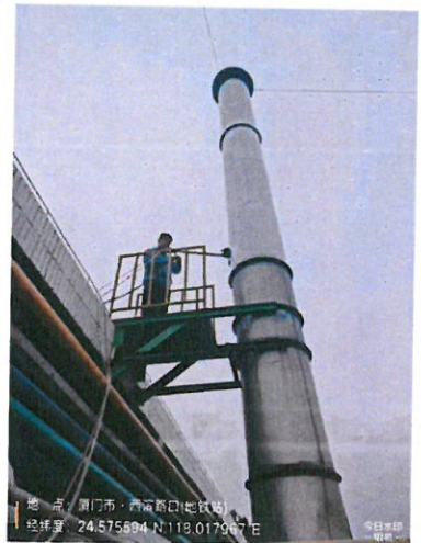
202 成型车间排气筒出口 (DA042/42 号排气筒)
