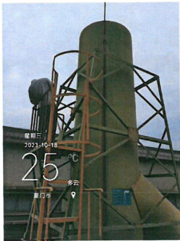
05 车间硫化车间排气筒出口 (DA004/4 号排气筒)
