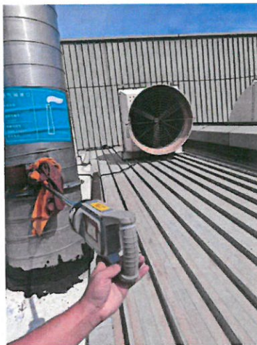
303 车间硫化车间排气筒出口 (DA018/18 号排气筒)
