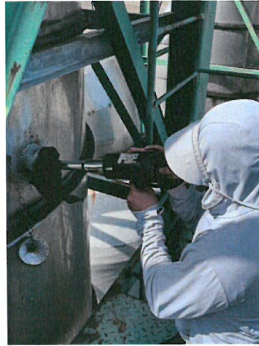
504 车间硫化车间排气筒出口 (DA0024/24 号排气筒)
