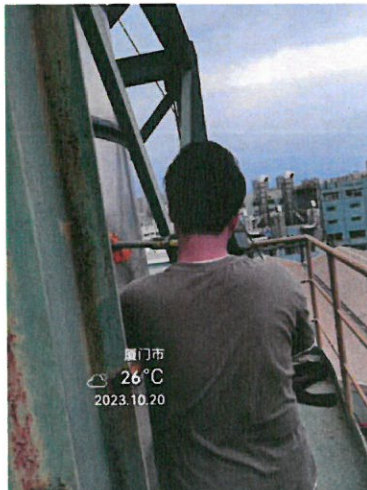
203 车间硫化车间排气筒出口 (DA027/27 号排气筒)
