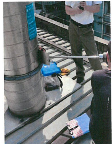
303 车间硫化车间排气筒出口 (DA016/16 号排气筒)
