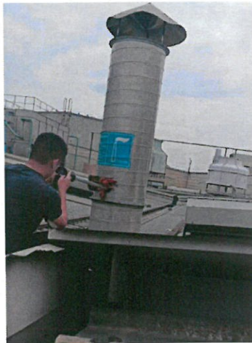
303 车间硫化车间排气筒出口 (DA012/12 号排气筒)
