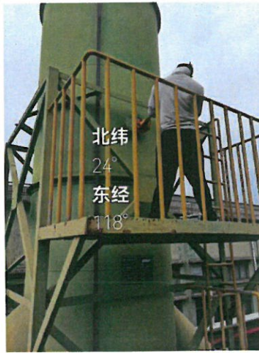
05 车间硫化车间排气筒出口 (DA005/5 号排气筒)
