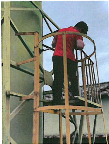
05 车间硫化车间排气筒出口 (DA007/7 号排气筒)
