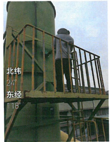
05 车间硫化车间排气筒出口 (DA006/6 号排气筒)
