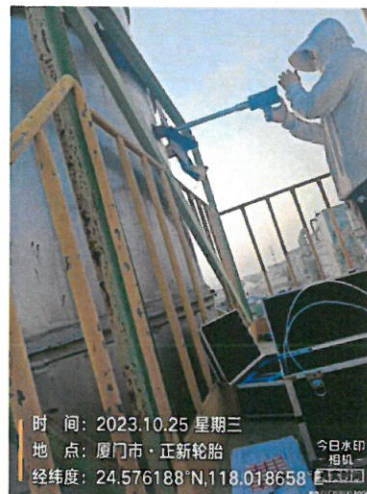
306 车间硫化车间排气筒出口 (DA030/30 号排气筒)
