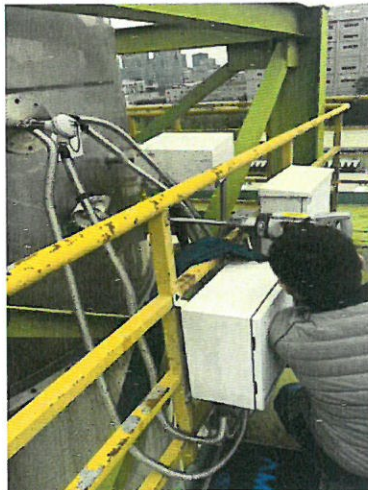
105/205 车间硫化车间废气处理设施 排气筒出口 (DA004)
